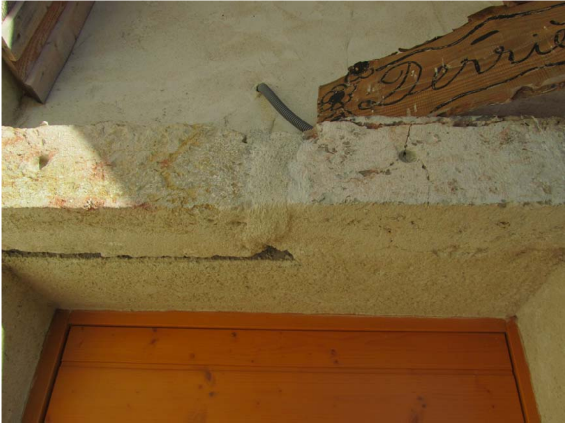
Une ancienne pierre aura au moins servi comme linteau de porte. On voit encore la marque des trous pour les barres de fer.
